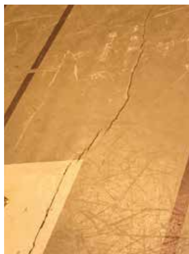
Un sol qui a bien souffert
