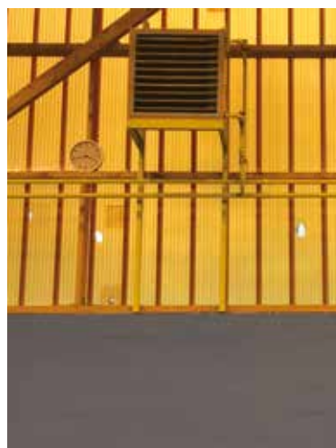
Le bardage endommagé
